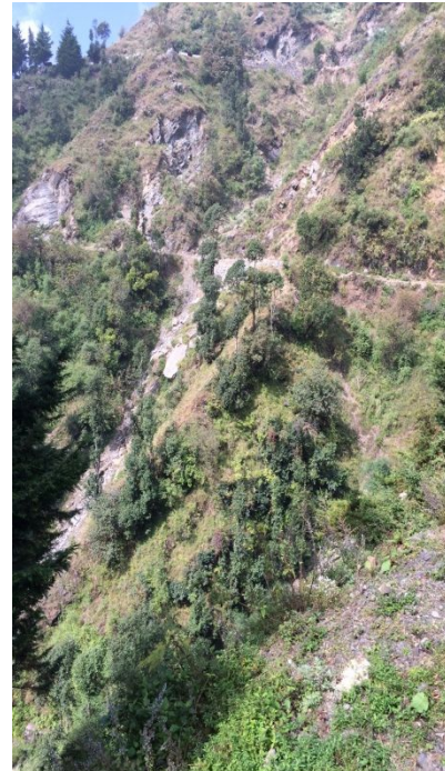
【地すべり状況】
