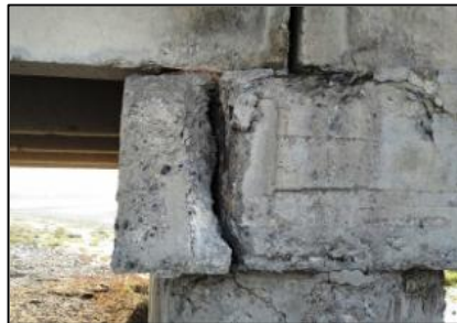
(崩壊寸前の橋脚台座部)
