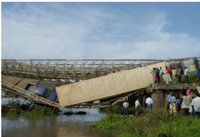
既存橋梁の落橋事故
