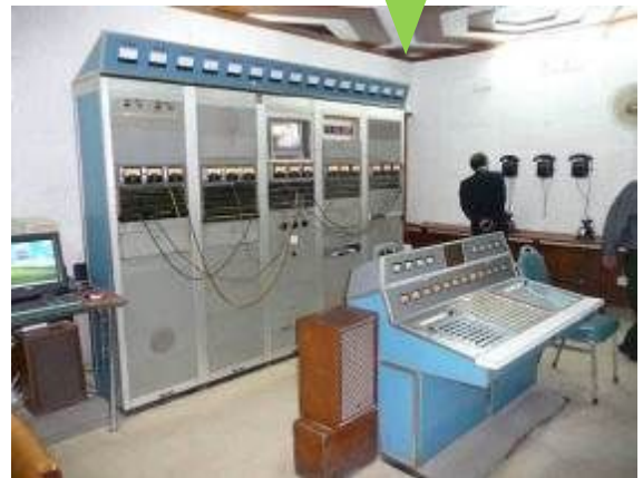
老朽化したイスラマバード本局のスタジオ機材
