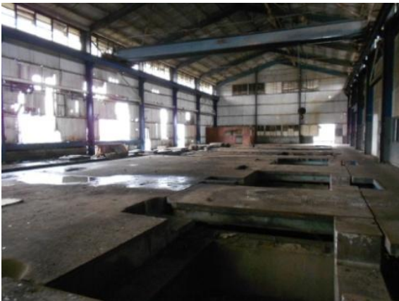
内戦で破壊されたブッシュロッド発電所
