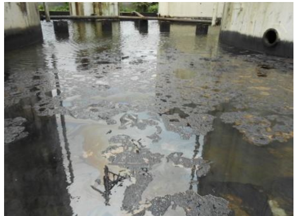
廃油と汚水により使用不能の給油タンク
