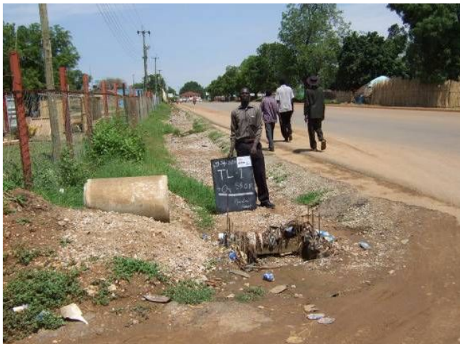
破損した配水管
