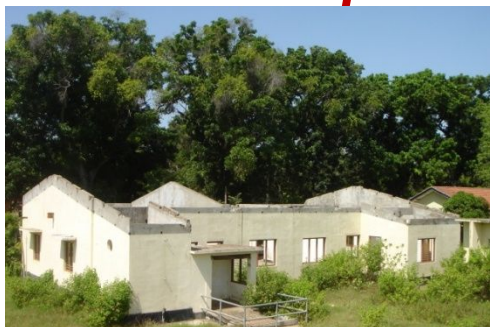
破壊された上水関連施設 (屋根が消失している)
