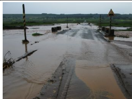
雨期に冠水する道路
