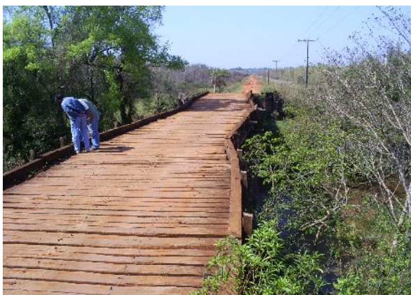
【老朽化した木造橋梁】
