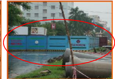
【デリーメトロを見習った安全対策(防護壁設置)】
