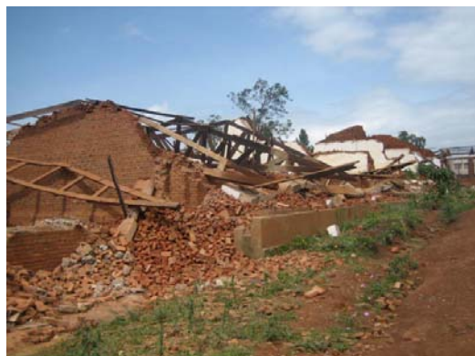
地震直後の状況
