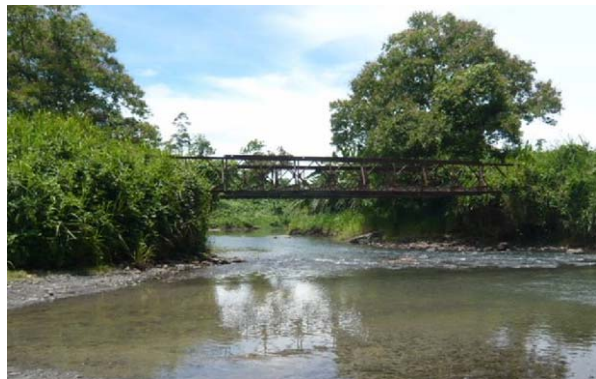
現状 (使用不可となっている)
