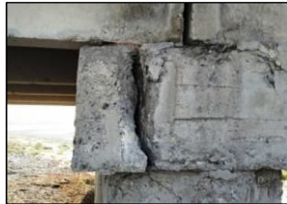
(崩壊寸前の橋脚台座部)
