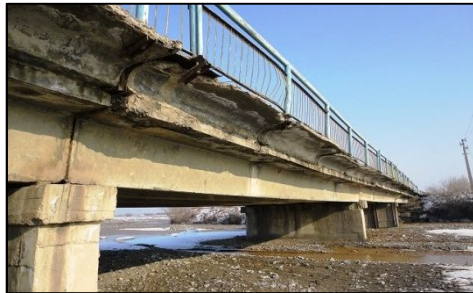
(損傷・老朽化が著しい橋梁)
