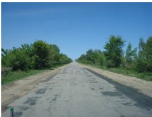
イシククリ湖南側の支援対象道路。 20 年以上前の舗装でポットホール補修跡が多い。
