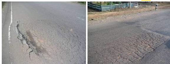
現状：損傷した路面の例
