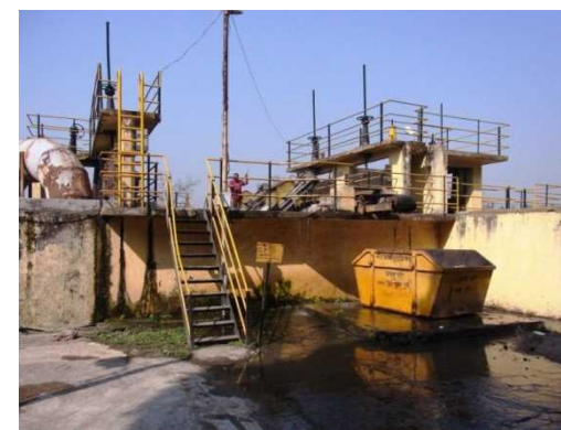
【老朽化した既存の下水処理場】
