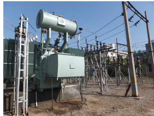
【33kV変圧器(例)】
