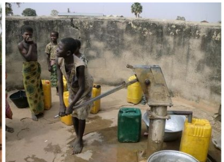
人力ポンプ給水施設の例
