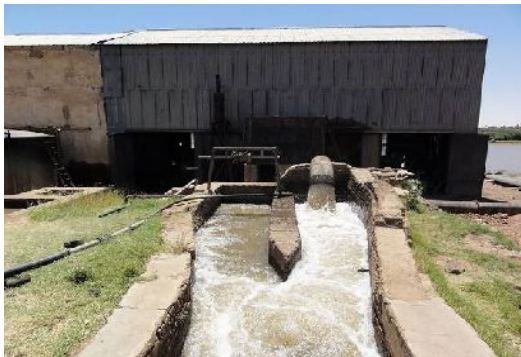
破損した水路
