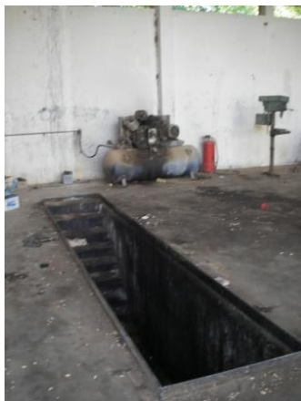
エアコンプレッサー小とメンテナンスピット
