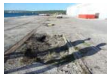
北埠頭の地盤吸出の様子
