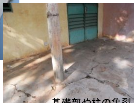
基礎部や柱の亀裂
