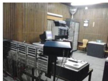
コントロール室
