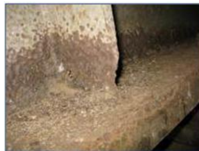
写真3 腐食が進む部材
