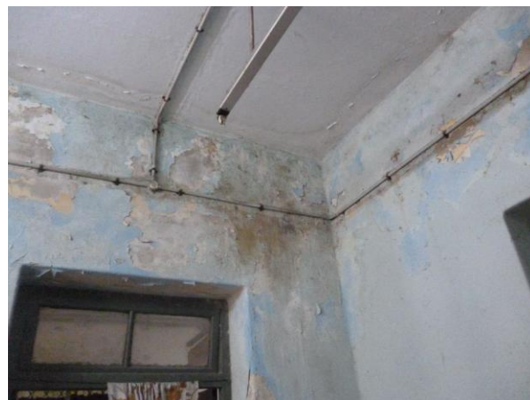
診察室の壁も補修が必要
