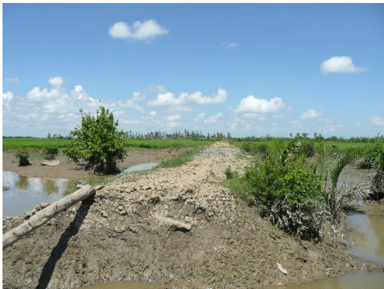
(写真1) 被災後の輪中堤の状況
