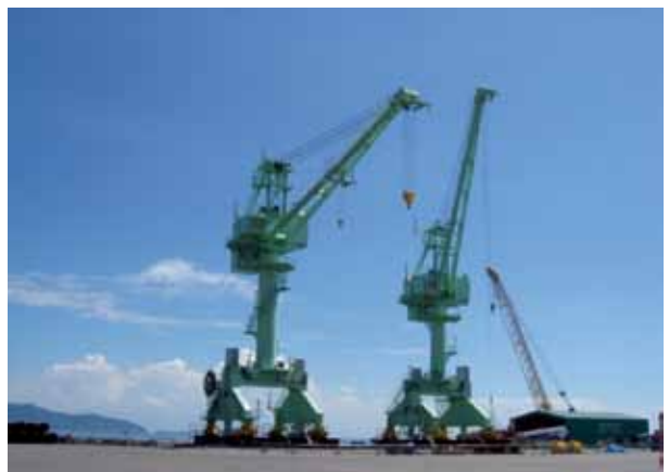
ジブクレーン(32トン・10トン)
