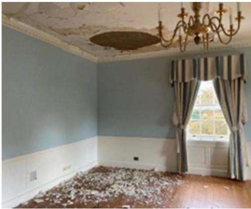
雨漏で天井崩落(在米大)
