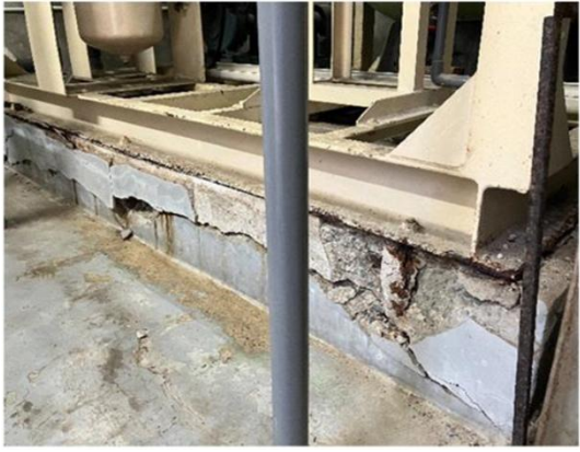
付属棟の基礎劣化(在ベトナム大)
