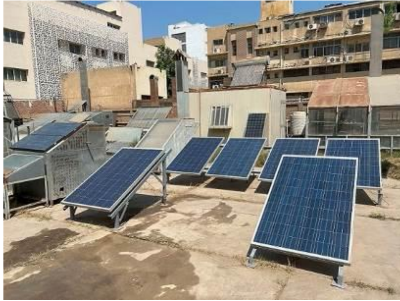
写真 エジプト国立研究所に設置された太陽光パネル
