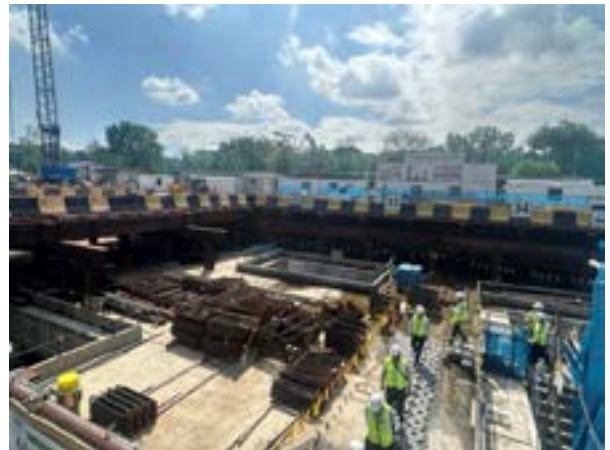
フィリピンでの有償資金協力「マニラ首都圏地下鉄事業」の建設現場（5月、フィリピン・マニラ）
