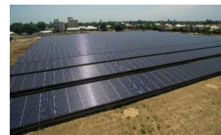
製塩工場横に設置された太陽光パネル (ケニア)
