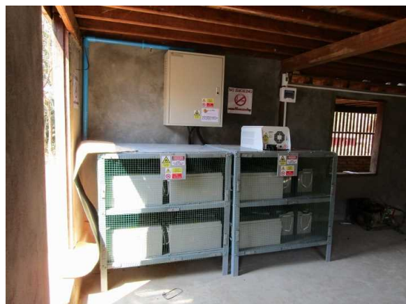
写真36: パソコン教室向けバッテリーシステム
