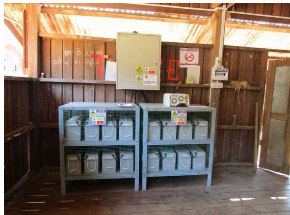
写真30： 生徒寮、食堂向けバッテリーシステム
