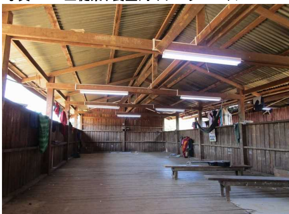
写真31： 生徒寮の照明
