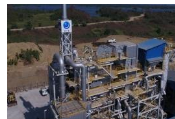
廃棄物発電施設
