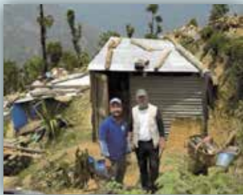
地震被害後のネパールの被害調査
