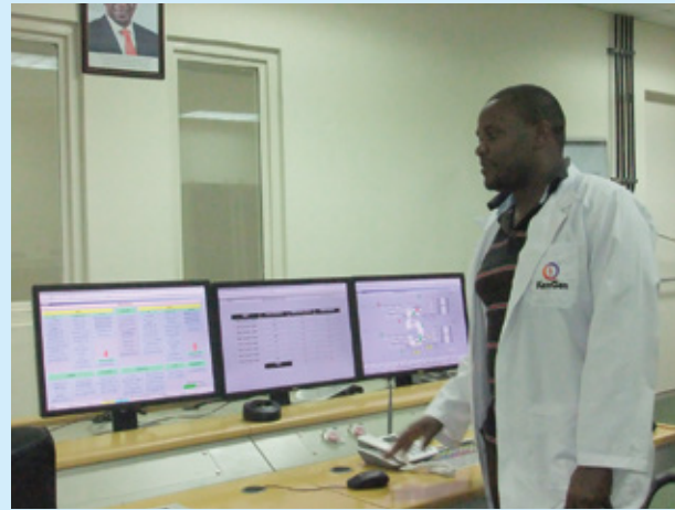
オルカリア地域の地熱発電所のコントロールルーム (画像提供: JICA)
