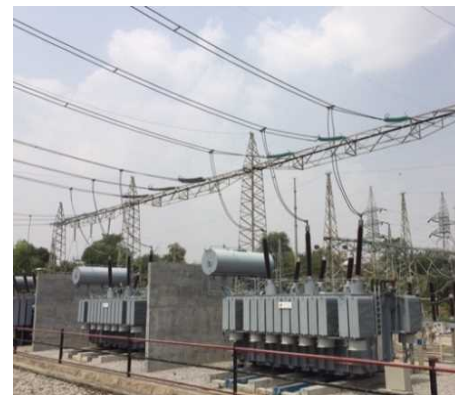
ブルハン変電所(変電施設)
