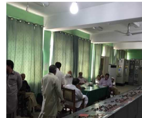
ブルハン変電所(制御室)
