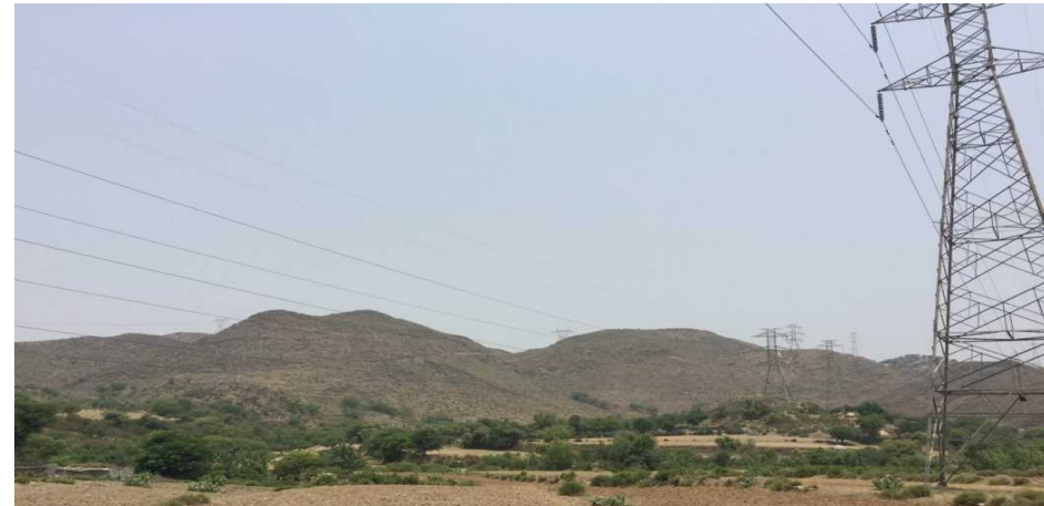
既存220kV送電線
