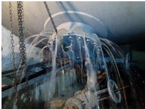
水車格納容器からの漏水
