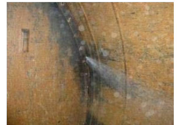
水車の入口弁からの漏水
