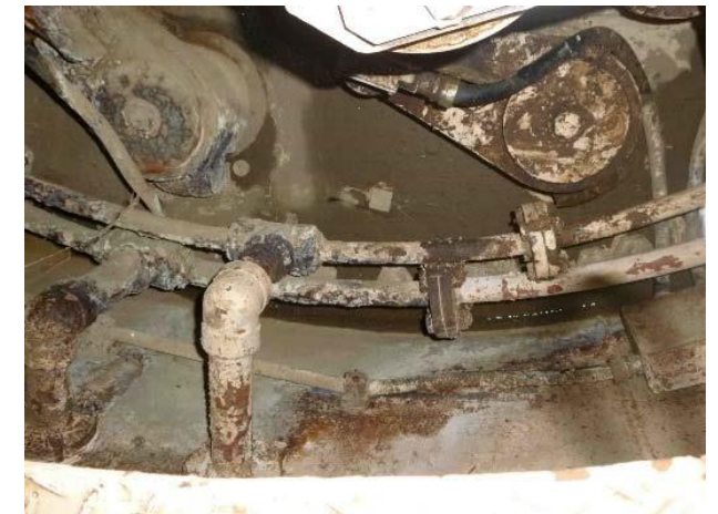
錆びついたパイプ
