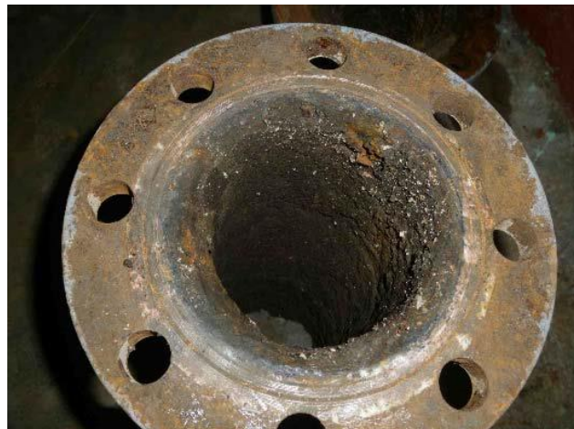
堆積物が付着したパイプ
