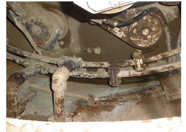
錆びついたパイプ
