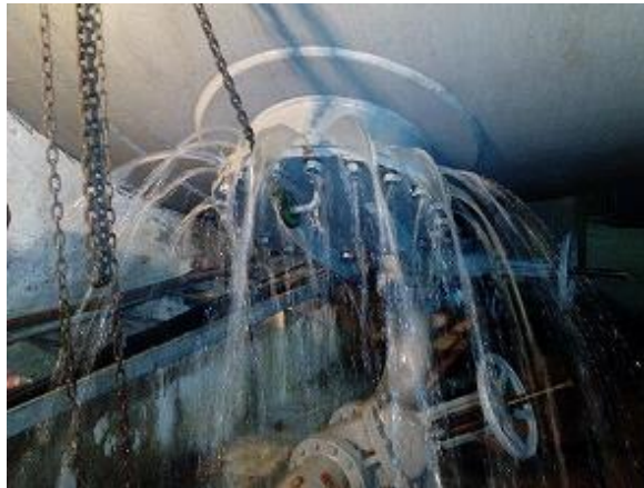
水車格納容器からの漏水
