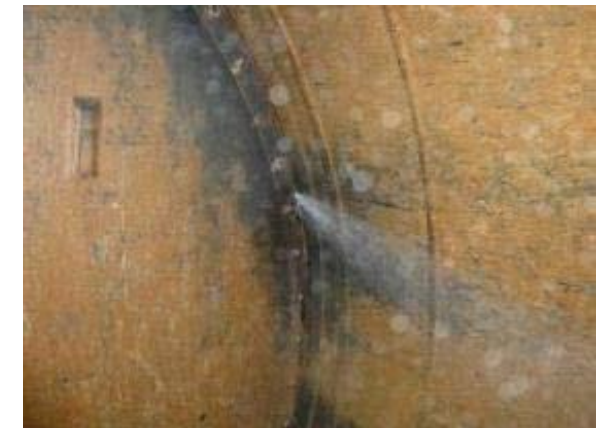
水車の入口弁からの漏水
