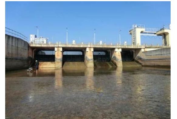
発電用取水ゲート全景
