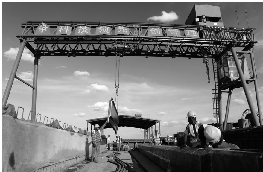
ケニアの首都ナイロビと大西洋岸のモンバサを結ぶ鉄道建設事業。 資金の9割は中国が出資している（ロイター / アフロ）
