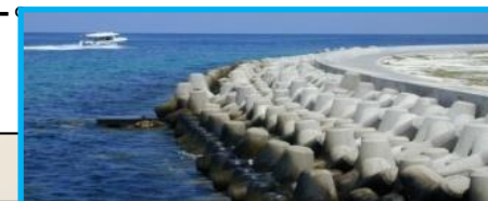
(1987～2002年の15年間をかけ、首都マレ島の高潮対策事業を実施。マレ島全周6kmにわたり護岸を建設。)
