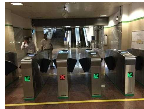
【Koyanbedu駅に設置された自動料金徴収システム(日本信号製)の様子(稼働済み)。】
