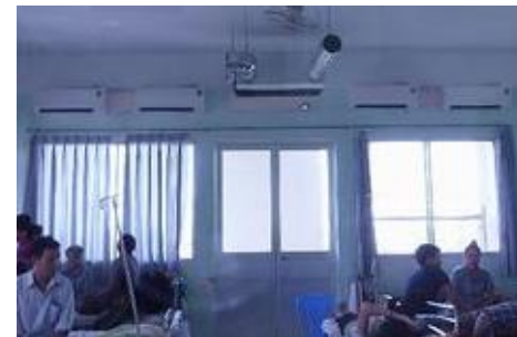
高効率エアコン及びEMS(三菱電機／ベトナム)
