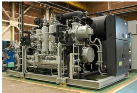
高効率冷却器(前川製作所／インドネシア)サイト①
