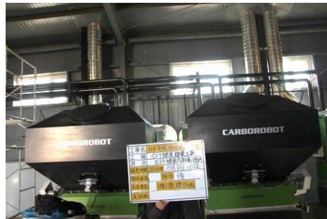
暖房用の高効率ボイラー(数理計画／モンゴル)サイト②
