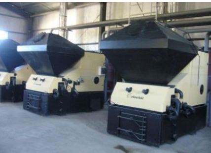
暖房用の高効率ボイラー(数理計画／モンゴル)サイト①
