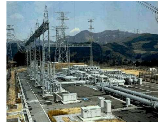
【屋外GIS変電所 完成例(500kV)】
