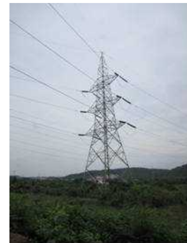
【既存の送電線及び鉄塔】
