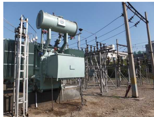
【33kV変圧器(例)】
