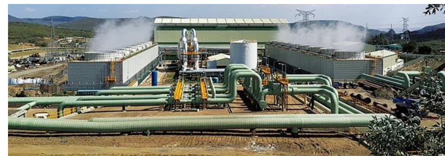
計画づくり、資源開発、発電所建設、送配電を包括的に支援した地熱開発（ケニア）発電所のタービンは日本メーカーの製品が活用されている。
