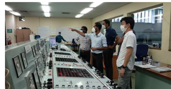
再生可能エネルギーの導入を念頭にした電力マスタープラン策定・実施支援（スリランカ）
