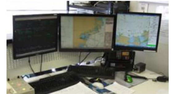
洋上の船と陸上の本部間での通信手段を強化するための通信システムの供与
