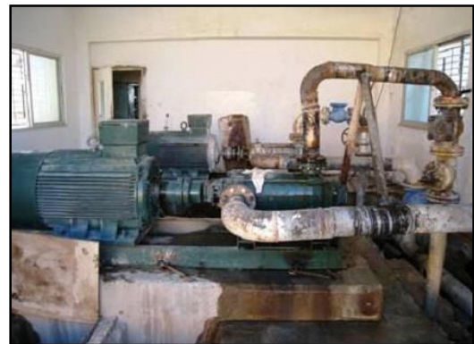
老朽化が激しく水漏れが発生している ポンプ場
