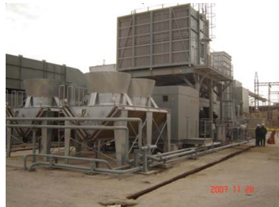
設置された発電プラント
