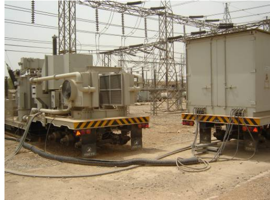
ランディアに配置された変電設備
