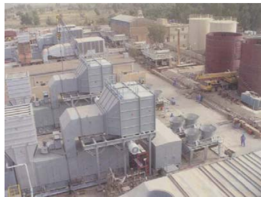
発電プラント2号機および3号機全景
