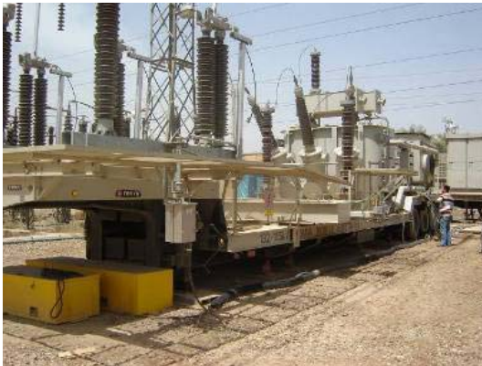
イスカン・アル・キールに配置された変電設備
