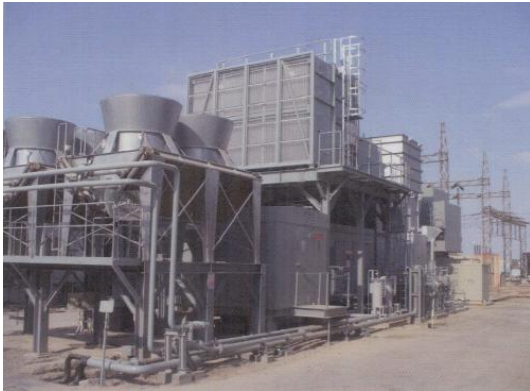
完成後の発電プラント5号機
